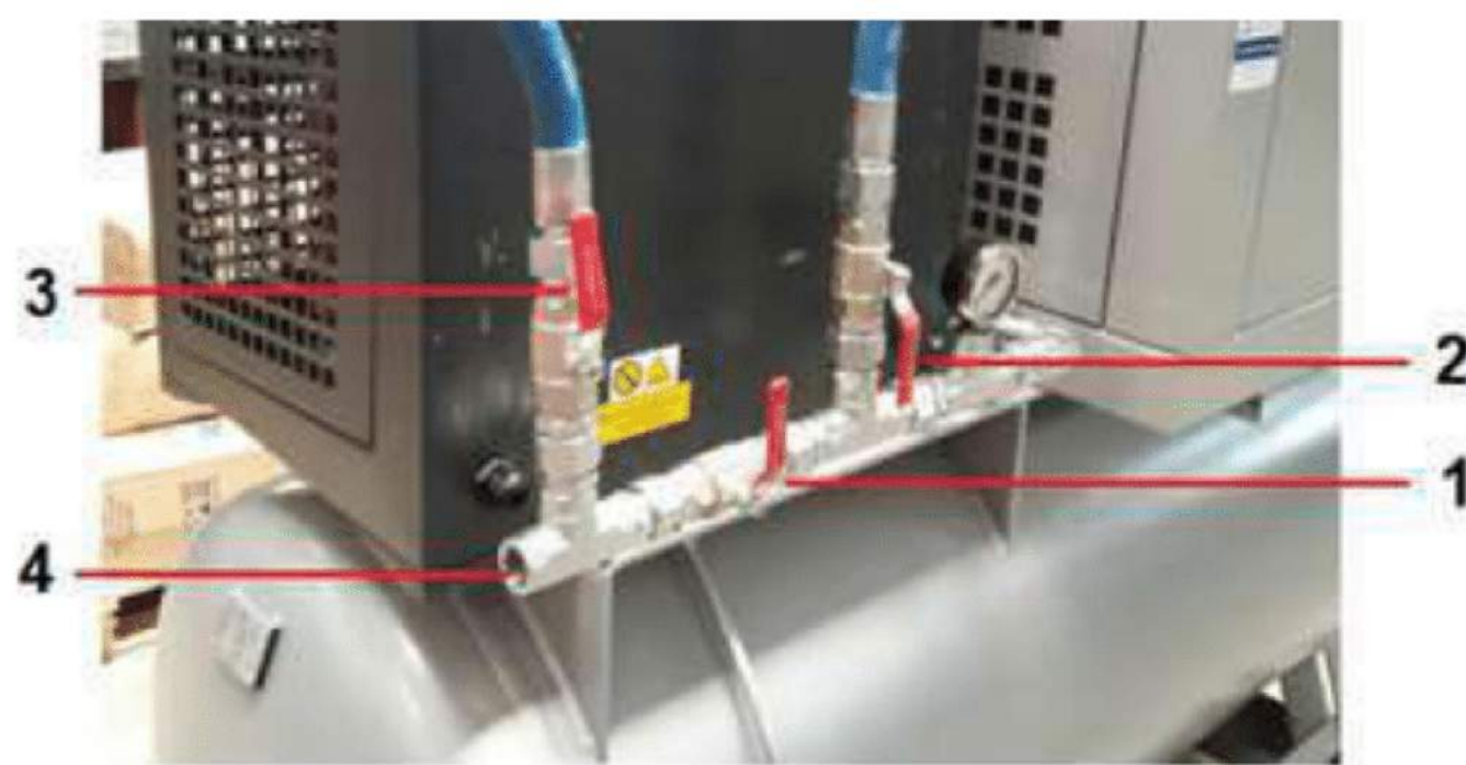
Рисунок-13 Пример сушилки, установленной на ресивере
